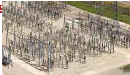
Un poste Transport Blocaux
