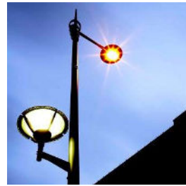
Pilotage des réseaux d'éclairage public
